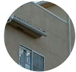
専用板を使用しなかった場合の 経年後の不具合事例
