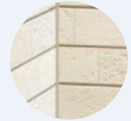
シーリングが劣化した状態(イメージ)
