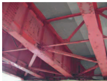
フタル酸樹脂 (16年1ヵ月経過) 既に塗膜劣化が著しい
