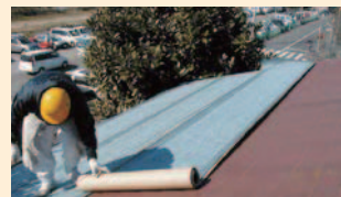
片面粘着式のルーフィング材を既存の化粧スレートの上から葺いていきます。
