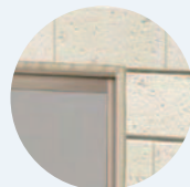
シーリングが劣化した状態(イメージ)
